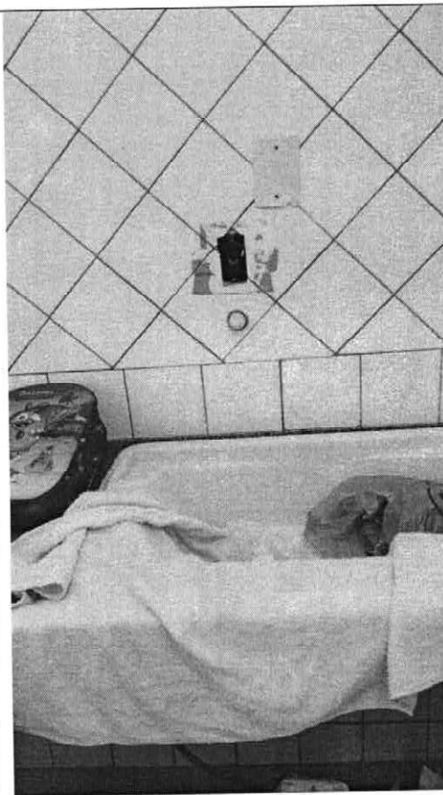
Ausência de torneira com aquecimento elétrico de uma das banheiras junto ao trocador, havendo inclusive exposição da fiação elétrica
