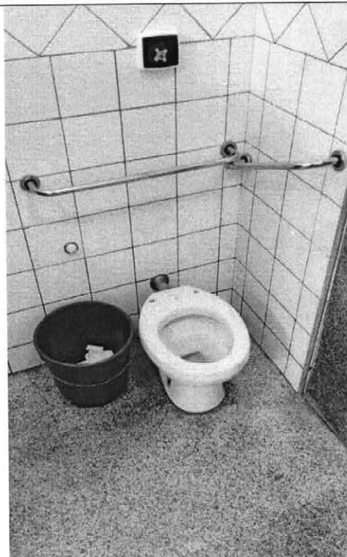
Vaso sanitário sem tampa, válvula de descarga sem proteção e ausência de papelreira
