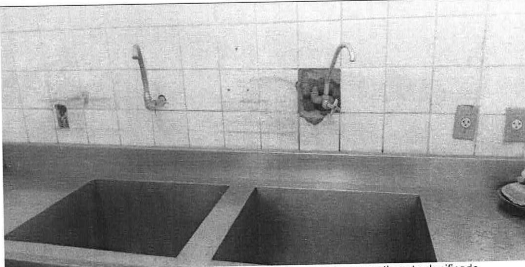
Tomada de energia sem proteção, com fiação exposta e revestimento danificado
