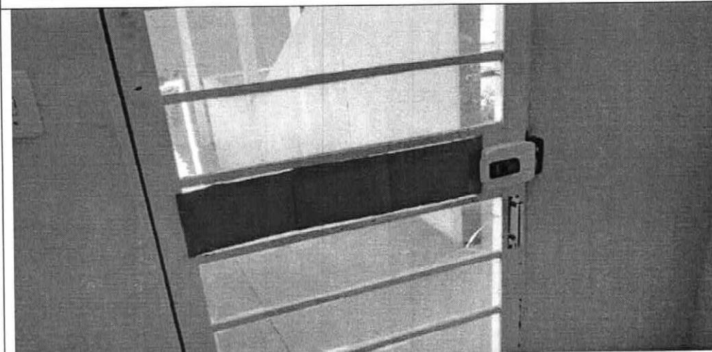
Porta com vidros quebrados
