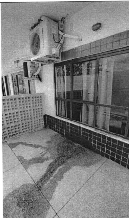
Escoamento de água verificado junto à condensadora de ar, por possível instalação inadequada
