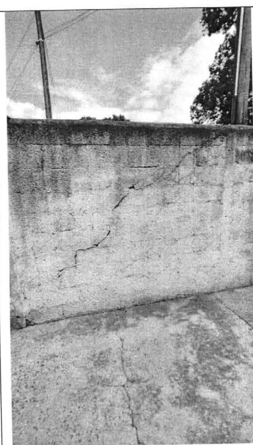
Fissuras no muro
