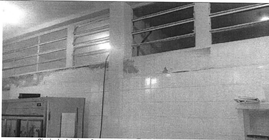
Sinais de deterioração na parede interna da área de preparo de alimentos
