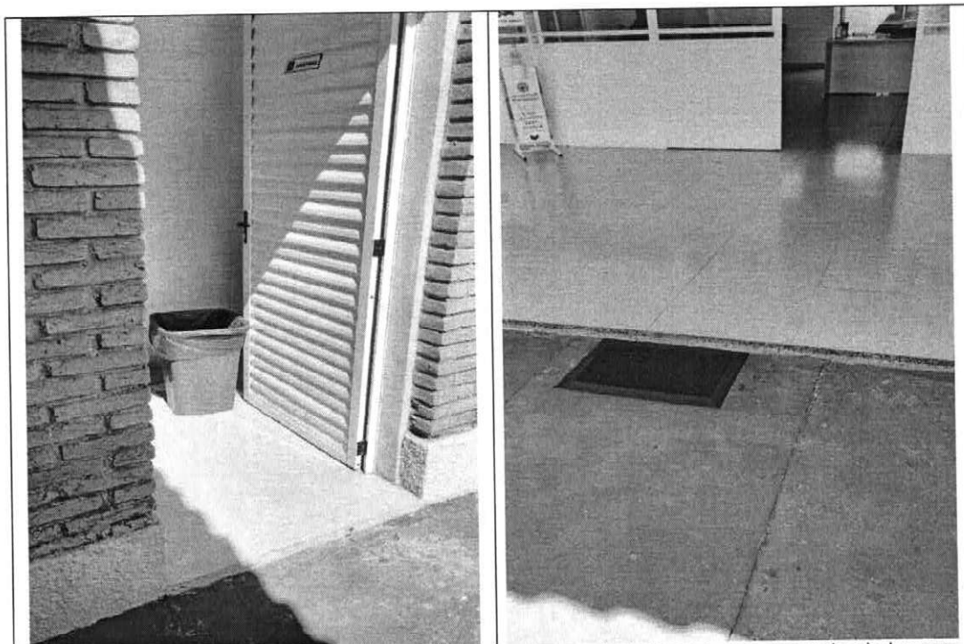
Falta de adequada acessibilidade no local (há alguns degraus inclusive para acesso ao banheiro para pessoas com deficiência e ausência de piso tátil)
