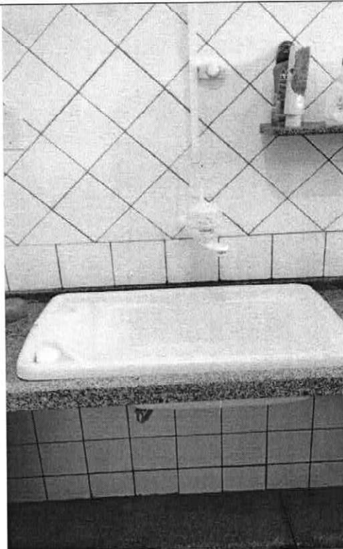
Torneira elétrica instalada muito próximo da banheira permitindo que seja alcançada pela criança, havendo risco de choque elétrico
