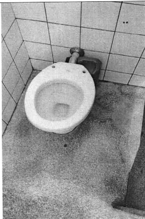
Sanitário sem tampa e com vazamento de água
