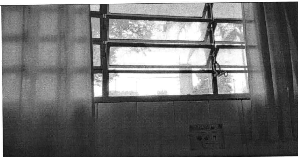
Janela da cozinha onde são preparadas algumas refeições intermediárias servidas na unidade sem tela milimetrada
